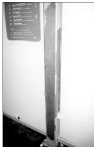
Abplatzungen am feuerverzinkten Stahlträger einer Autowaschanlage. Quelle (zwei Fotos): Dr. Herrmann
