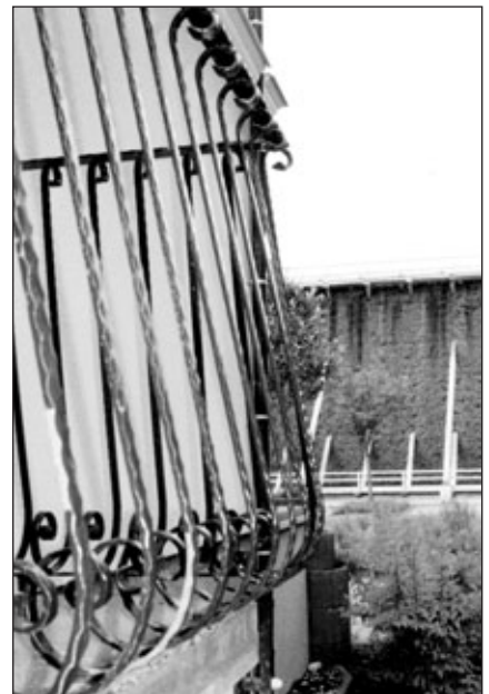
Durch die Nähe zu einem Salzsole-Gradierwerk kam es bereits nach sechs Monaten zu Abplatzungen und Weißrostbildung.
