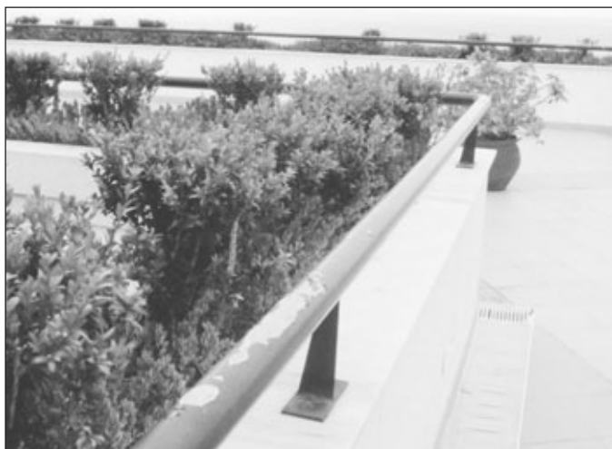
Feuerverzinkter Handlauf in nächster Küstennähe: Auch hier kann es nach relativ kurzer Zeit zu signifikanten Lackabplatzungen vom Substratuntergrund kommen.
