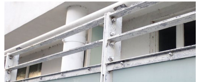
Sanierungsbedürftige verzinkte Balkonanlage mit Nasslack-Beschichtung nach 25 Jahren maritimer Beanspruchung.
