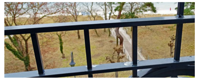
An der Balkonanlage mit Seeblick zur Ostsee sind die Lackfilmablösungen von der verzinkten Stahlkonstruktion deutlich erkennbar.
