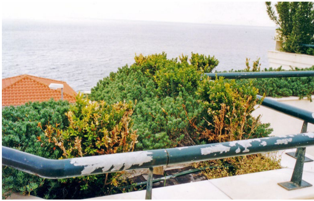
Korrosionsschäden in Verbindung mit Weißrostbildung können zu großflächigen Ablösungen der Lackierung führen.
