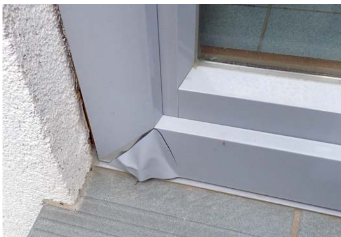
Die Pulverlackablösung am Gehrungsbereich durch ungenügende Lackfilmenthaftung ist die Folge einer nicht ausgebildeten Konversionsschicht an diesen Aluminium-Klipp-Profilen.
