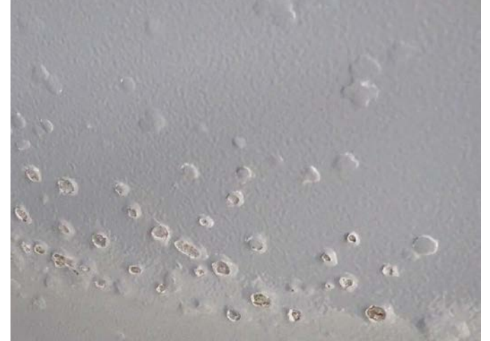
Die voranschreitende Weiß- und Rotrostausbildung an diesen verzinkten Bauelement zeigt, dass die Eisenphosphatierung in diesem Fall eine ungeeignete Vorbehandlung ist.
