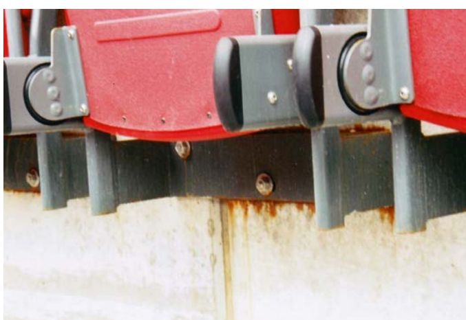
Die Sitze im Augsburger Fußballstadion weisen Korrosion auf. Eine Eisenphosphatierung mit Pulverlack-Einfachbeschichtung ist bei nicht-verzinkten Stahlteilen ein ungenügender Korrosionsschutz.
