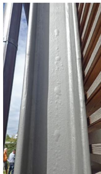
Blasenbildungen in der Deckbeschichtung, die aufgrund einer ungenügenden Zwischentrocknungszeit des darunter befindlichen Nasslack-Brandschutzanstriches entstanden.
