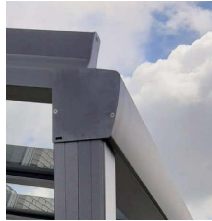
Eine ungünstige Dosierung von Rückgewinnungs- und Frischpulver kann signifikante Schwankungen im metallischen Erscheinungsbild des eingebrannten Lackfilms nach sich ziehen. In diesem Fall resultiert die uneinheitliche Optik aus Chargenschwankungen des Pulverlacks in DB 703 und unterschiedlichen Applikationszeiträumen mit Rückgewinnungsfahrweise.
